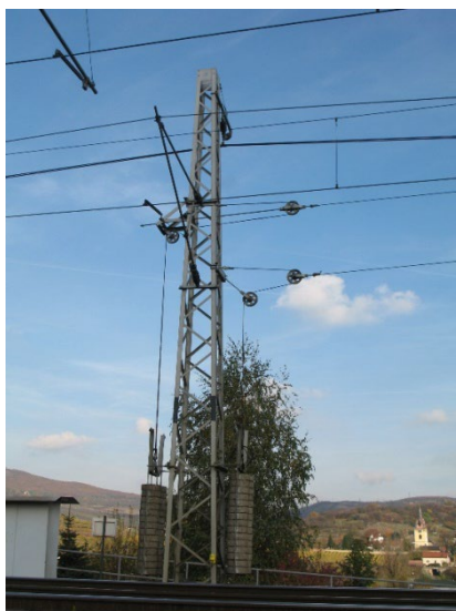
Obr. 6 Kladky napínající elektrické vedení
